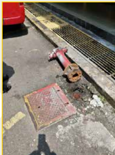
Aduan kerosakan Pili Bomba akibat dilanggar
